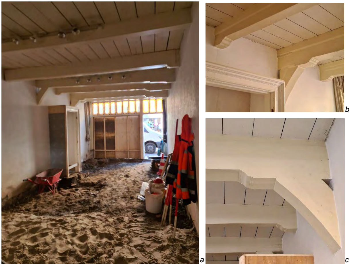
Afb.6-3 Authentieke delen van het houtskelet met consoles en sleutelstukken in renaissancestijl uit eind 16 de of begin 17 de eeuw, nog aanwezig aan de zuidkant bij de voorste drie balkvakken: a-b vanaf de achterzijde (oosten), c vanaf de straatzijde (westen). Aan de noordkant zijn ze afgekap of vervangen, ook vooraan in het pand.
