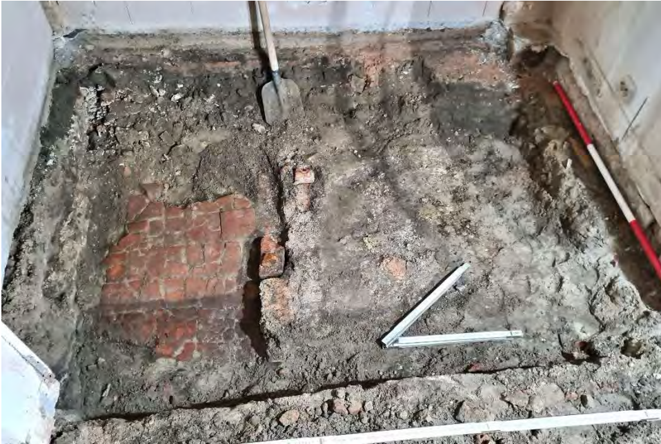
Afb.6-11 Fundering 2B in het achtervertrek, links ertegenaan plavuizenvloer 3E, vanuit het westen
