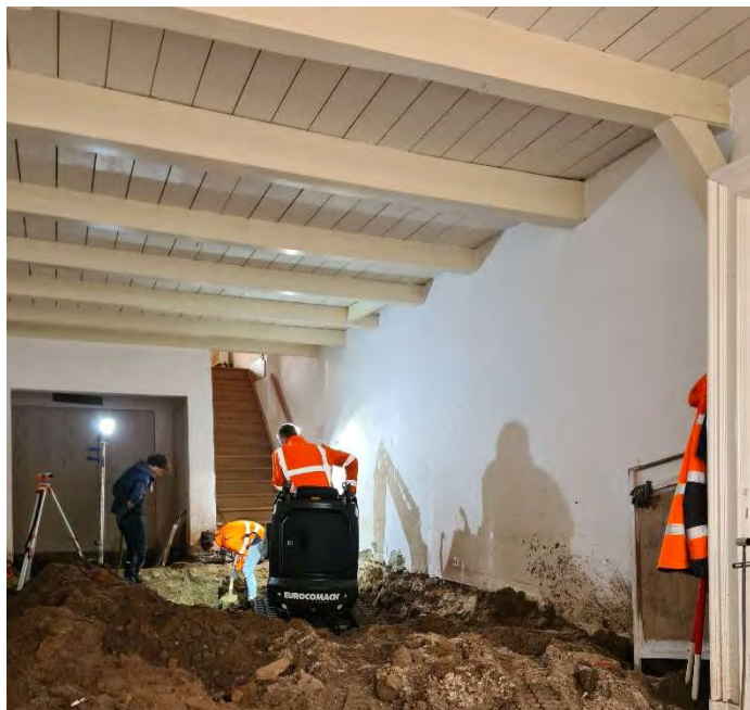
Afb.6-5 Graafwerk in het achtervertrek Het achterhuis heeft geen houtskelet maar een balklaag op de zijmuren gelegd. Hierin is (boven de kleine graafmachine) de raveling voor een schouw tegen de zijmuur te zien
