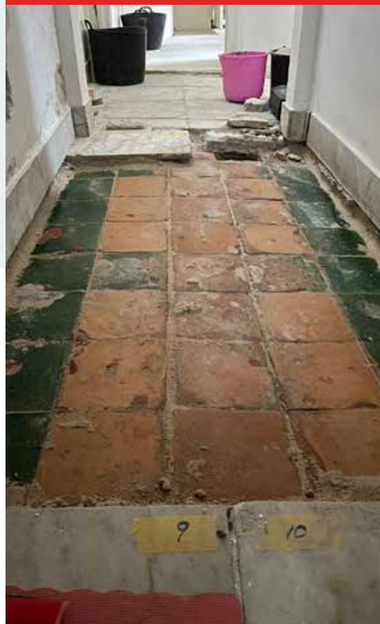
Onder de marmeren vloer in de gang bleek nog een veel oudere plavuizen vloer te liggen.
